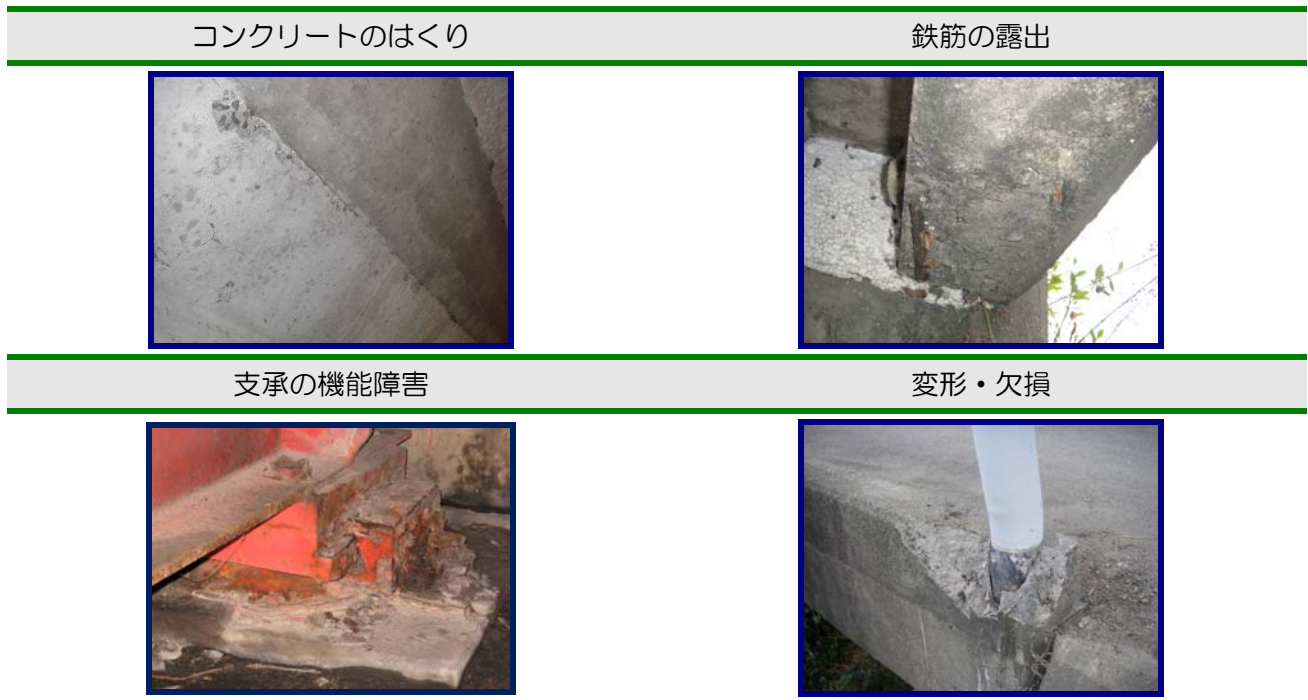
図 2 橋梁の主な損傷例
